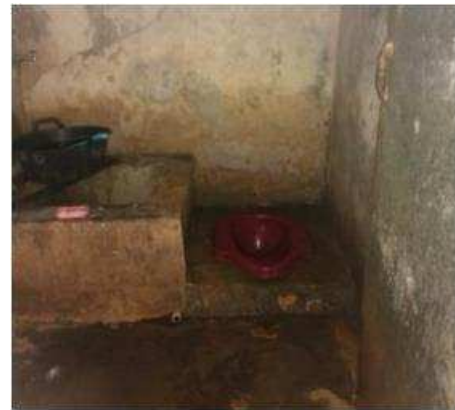
Gambar 8. Kondisi awal toilet sebelum perbaikan
