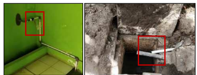
Gambar 7. (a) stop kran air bersih, dan (b) pipa air kotor ke bak kontrol
