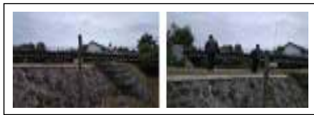
Gambar 3. Talud Pembatas Sungai Gajah Wong di Segmen Sorowajan Sumber : Dokumentasi Pribadi, 2017
